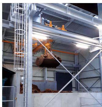
Site de Gazteam Energie à Combrand (79) - Pont digesteur.
