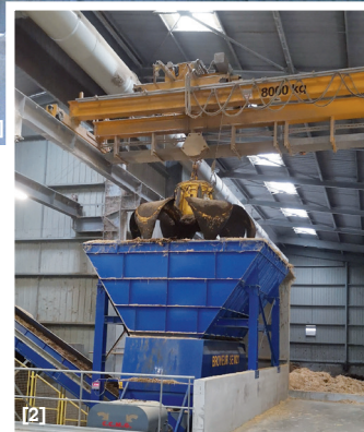
[1] Site de Bioenergie Vihiers (49) - Pont fumiers. [2] Site de Gazteam Energie à Combrand (79) - Pont fumiers.
