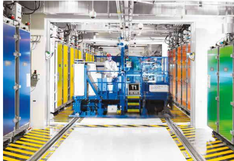
Stations de conditionnement de l'UF6 pour GB2
